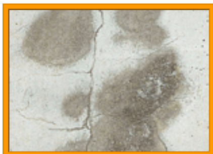
気になるコンクリート面の色ムラ
