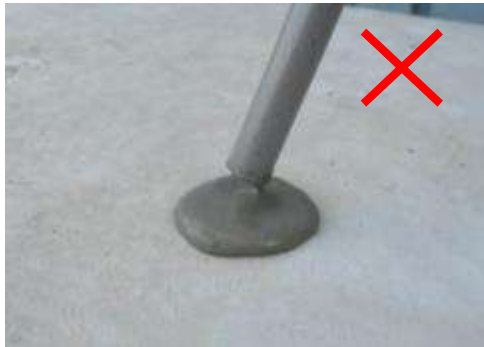
写真 4-17 混合後のアンカー材料(不良品)
