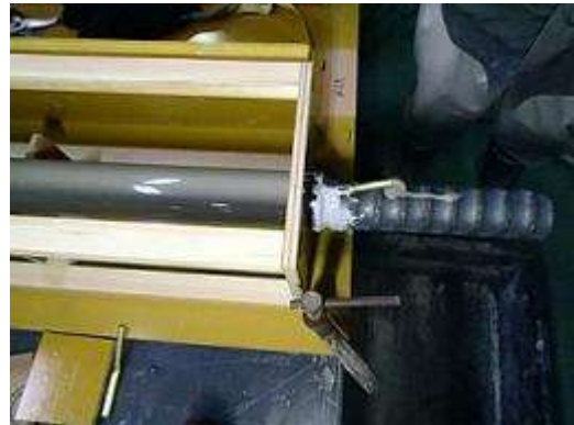
貫通孔 エア抜き側
