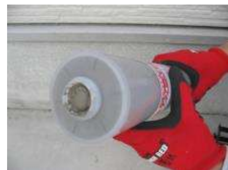
排出口(エア抜き後)
