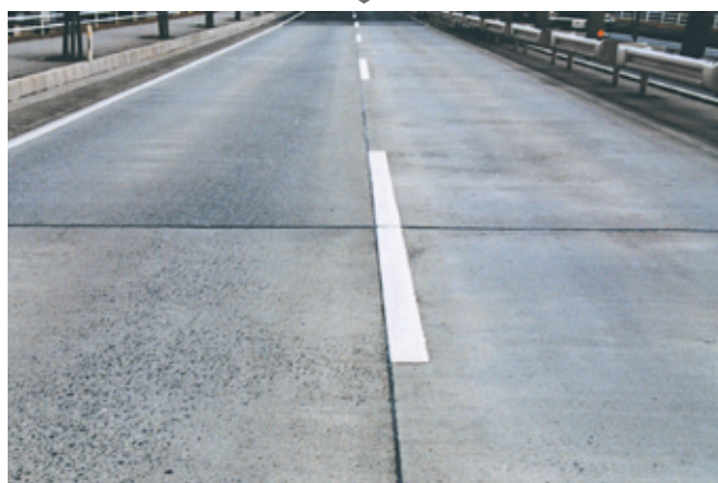
施工3年半経過後の状況 (右側車線に使用。ひび割れは認められません。)
