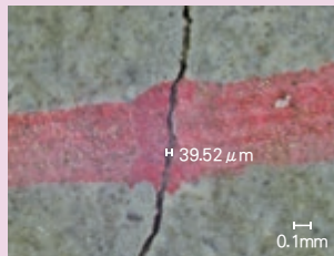
④ 補修後荷重を加え、強制的にひび割れさせた状態
